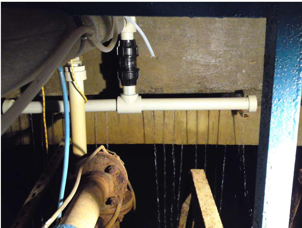
Zařízení pro oxidaci železa a manganu
