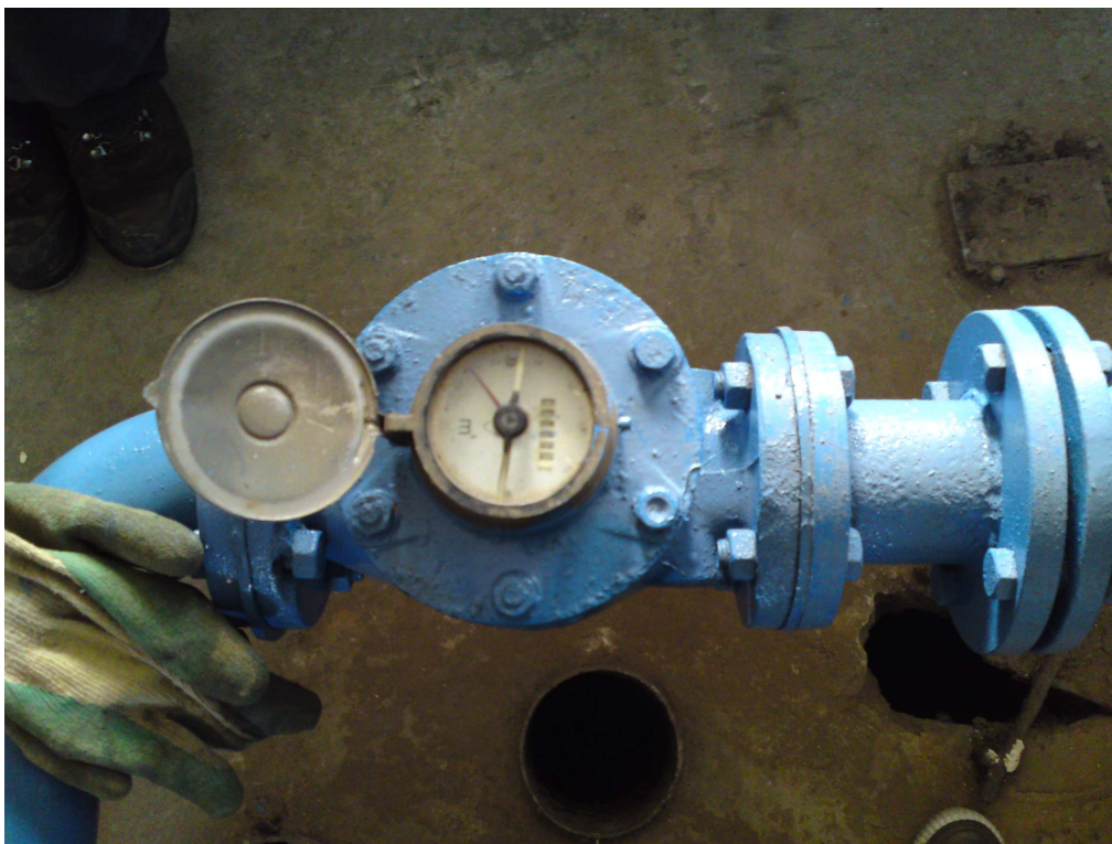
Vodoměr vyrobené vody
